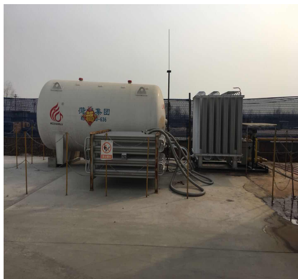
附图 2 天然气储罐
