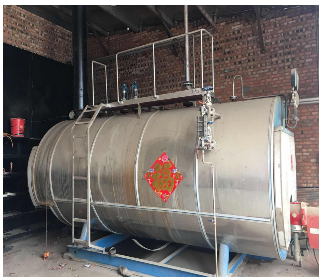
附图3 天然气锅炉
