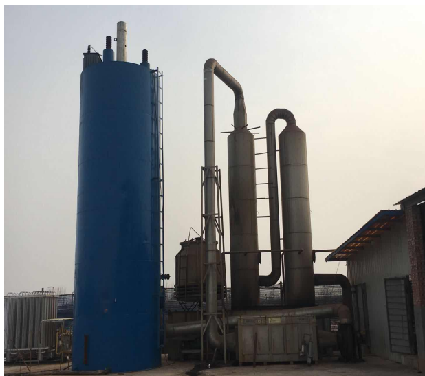
附图 1 上料搅拌工序废气处理设备
